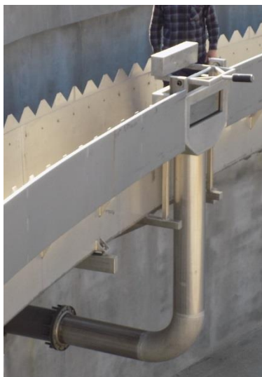
Zdjęcie 4 „Komora boczna cz. pływ. na Oczyszczalni Ścieków w Jaworznie”.
