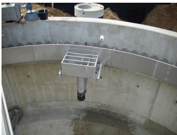
Zdjęcie 5 „Komora zanurzeniowa cz. pływ. na Oczyszczalni Ścieków w Tomaszowie Mazowieckim”.
