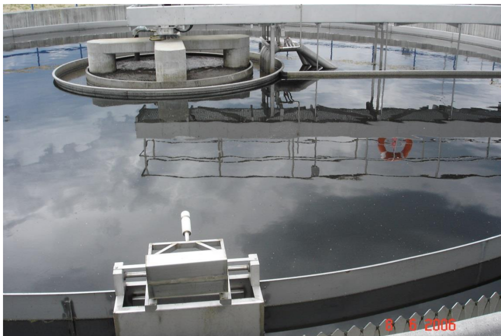
Zdjęcie 4 „Zgarniacz na Oczyszczalni Ścieków w Trzciance”.
