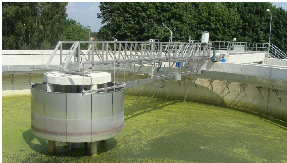
Zdjęcie 6 „Zgarniacz na Oczyszczalni Ścieków w Nowym Tomyslu”.
