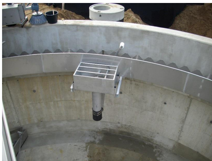
Zdjęcie 8 „Komora zanurzeniowa cz. pływ. na Oczyszczalni Ścieków w Tomaszowie Mazowieckim”.
