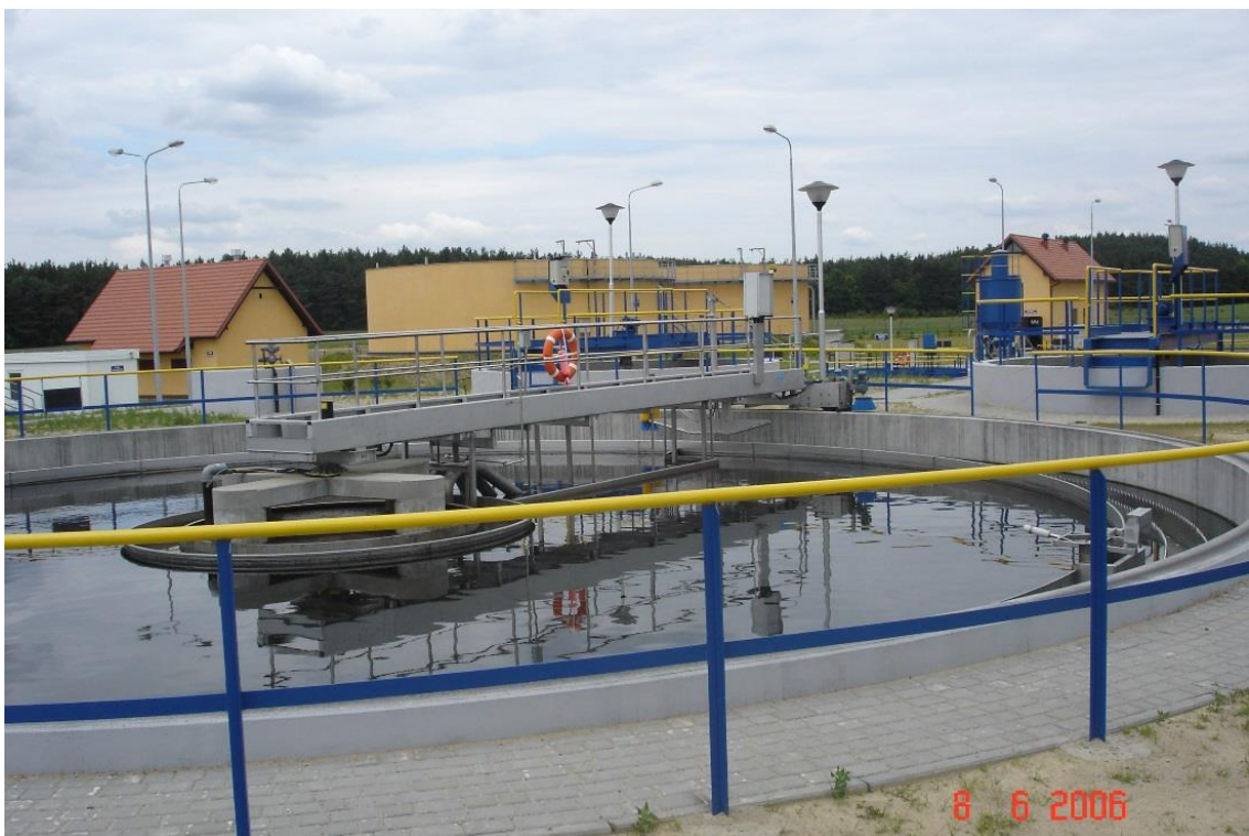
Zdjęcie 3 „Zgarniacz na Oczyszczalni Ścieków w Trzciance”.
