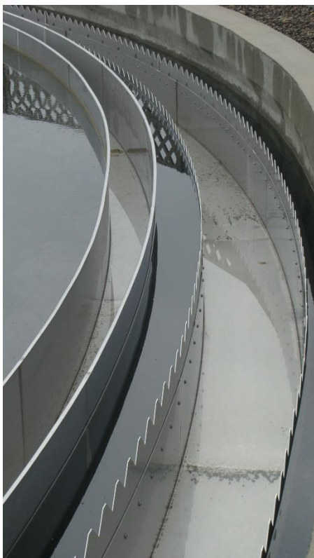
Zdjęcie 12 „Koryto przelewowe na Oczyszczalni Ścieków w Kluczach”.
