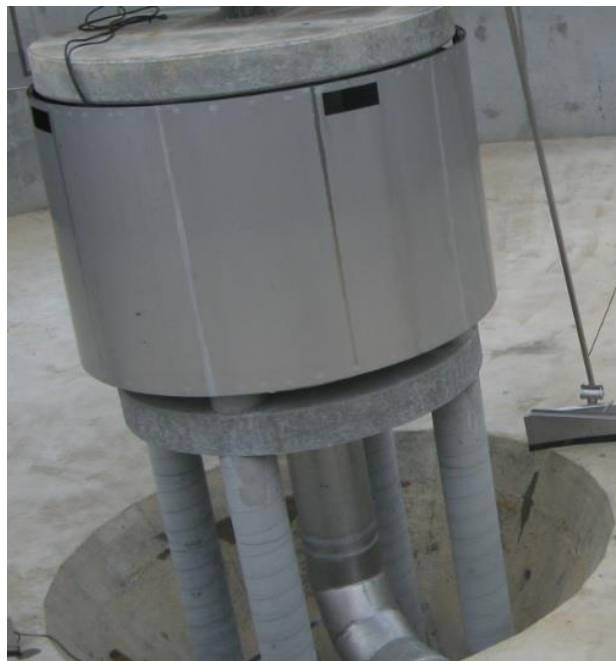
Zdjęcie 10 „Deflektor centralny z oknami wypływowymi na Oczyszczalni Ścieków w Rypinie”.
