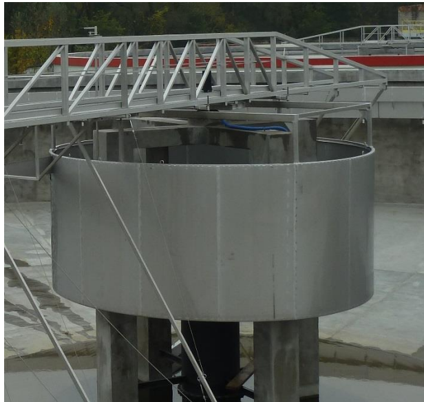
Zdjęcie 9 „Deflektor centralny podwieszony do pomostu na Oczyszczalni Ścieków w Jaworznie”.
