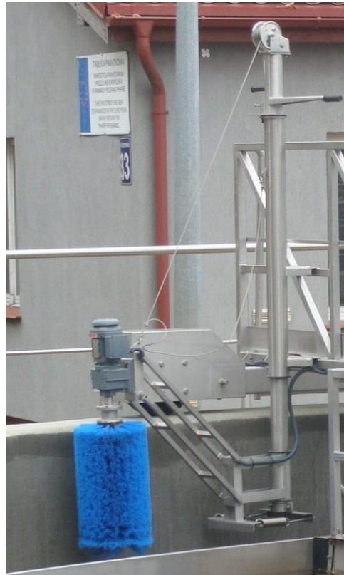
Zdjęcie 11 „Szczotka koryta przelewowego na Oczyszczalni Ścieków w Kołbaskowie”.
