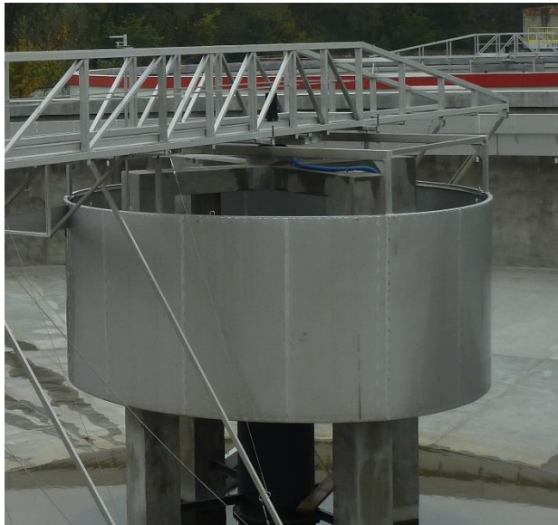
Zdjęcie 6 „Deflektor centralny podwieszony do pomostu na Oczyszczalni Ścieków w Jaworznie”.
