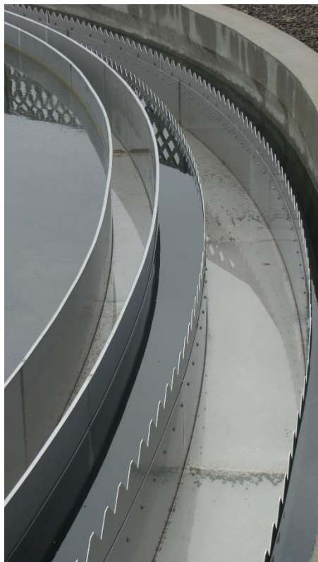
Zdjęcie 9 „Koryto przelewowe na Oczyszczalni Ścieków w Kluczach”.
