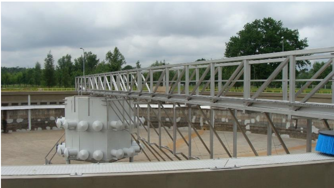
Zdjęcie 1 „Zgarniacz na Oczyszczalni Ścieków Kujawy w Krakowie”.
