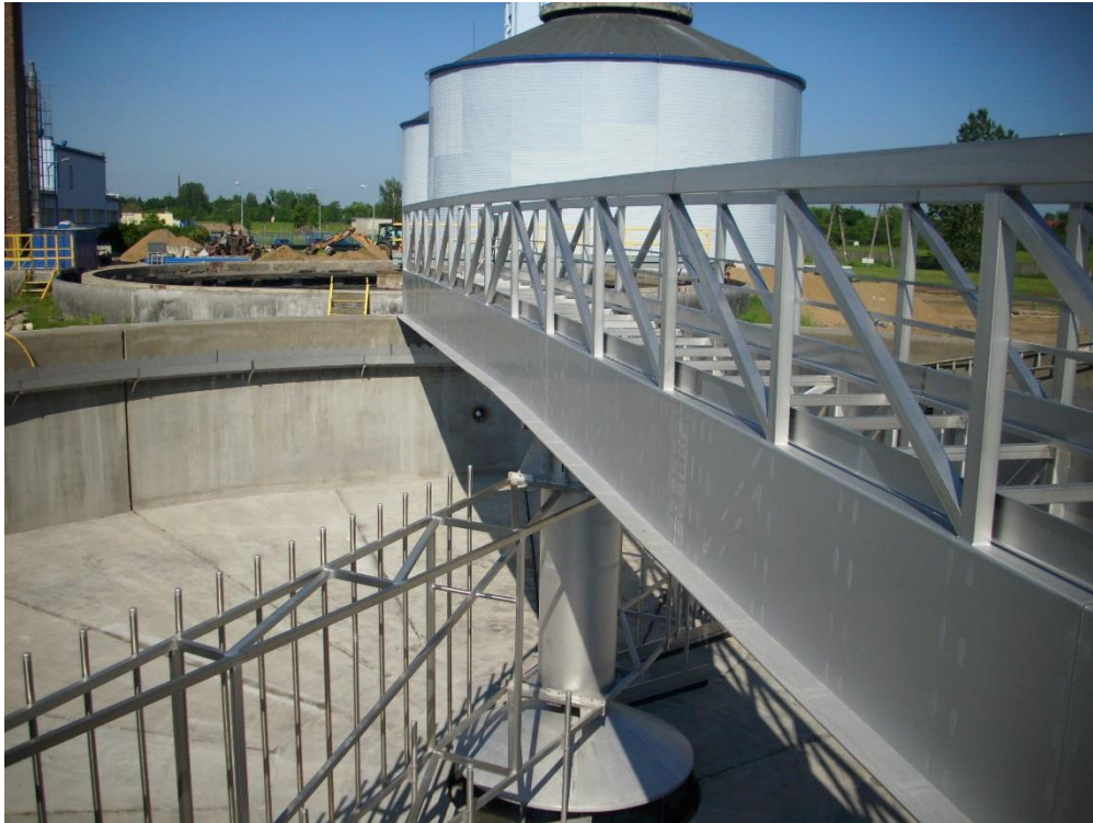
Zdjęcie 1 „Mieszadło prętowe na Oczyszczalni Ścieków w Legnicy”.
