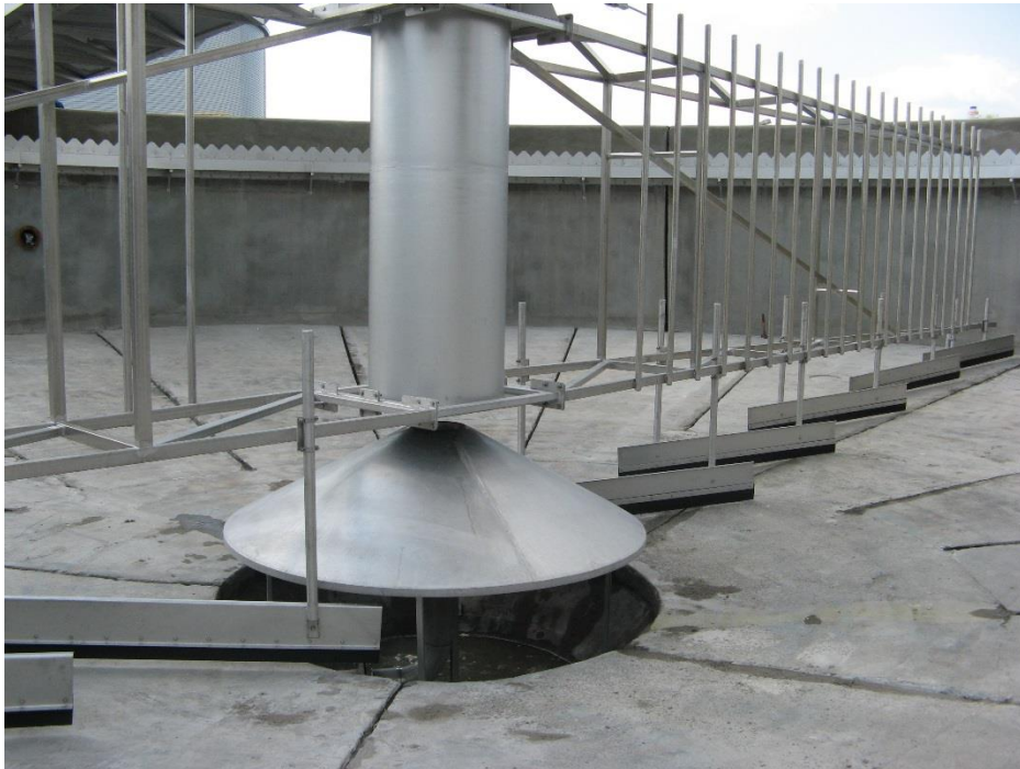
Zdjęcie 2 „Mieszadło prętowe na Oczyszczalni Ścieków w Legnicy”.
